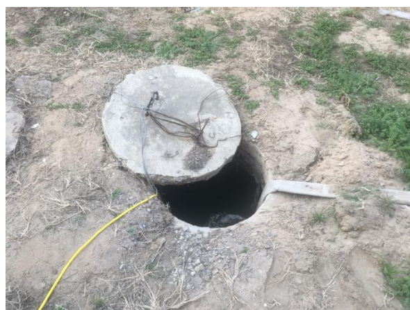
新乡东站变电所（化粪池）
