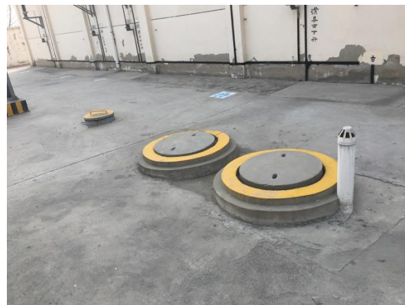
东明站变电所（化粪池）
